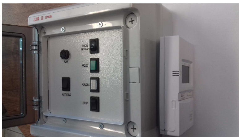
Ovl. rozvaděč SO1
